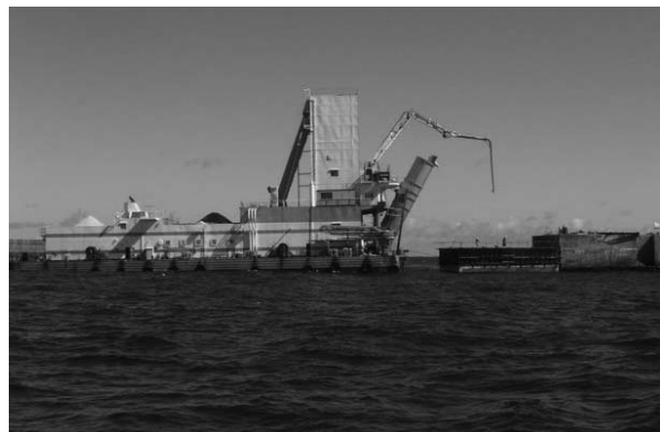
渡名喜漁港第1沖防波堤工事現場 コンクリート打設状況
