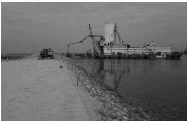
那覇空港滑走路増設護岸工事現場 コンクリート打設状況
