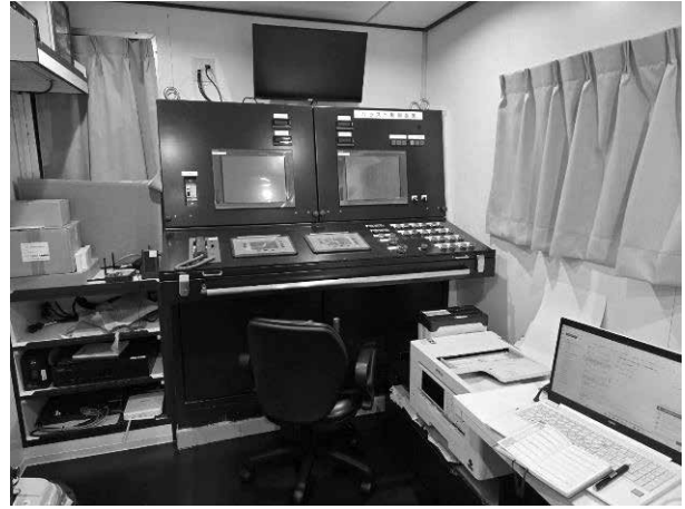
バラスト制御盤
