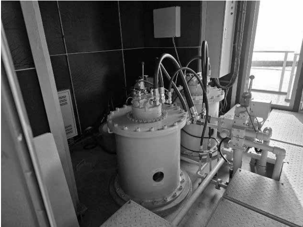
クレーン内部②
