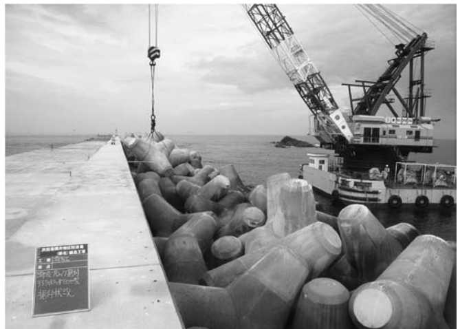
浜田港福井地区防波堤(新北)築造工事 消波ブロック据付状況 テトラポッド80型
